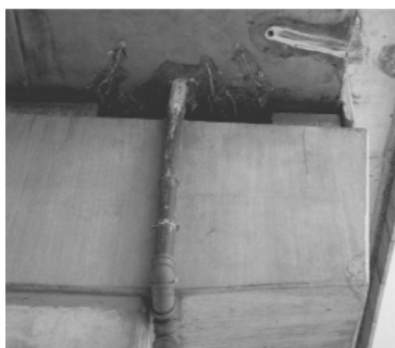
neredovito održavanje odvodnje uzrokuje oštećenja konstrukcije
