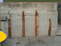
Opća korozija (karbonatizacija)
